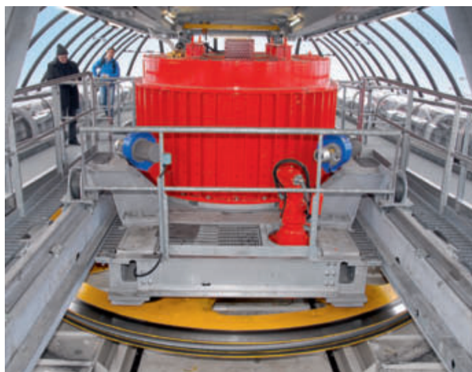
Прямой привод на верхней станции подъемника „Ochsalmbahn“ (Фото: J. Nejez)
