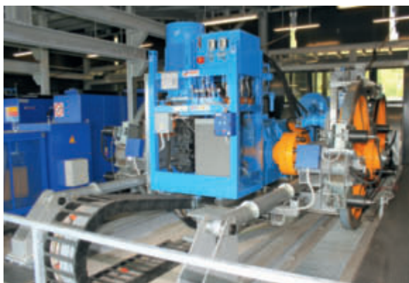
Einer der beiden hydraulisch gespannten Funifor-Antriebseinheiten in der Talstation.
