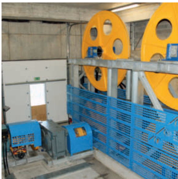
Der 315 kW starke Antrieb befindet sich in der Talstation.
